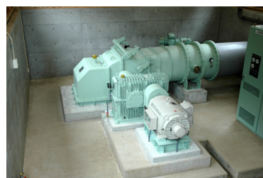
熊本県清和発電所クロスフロー水車
